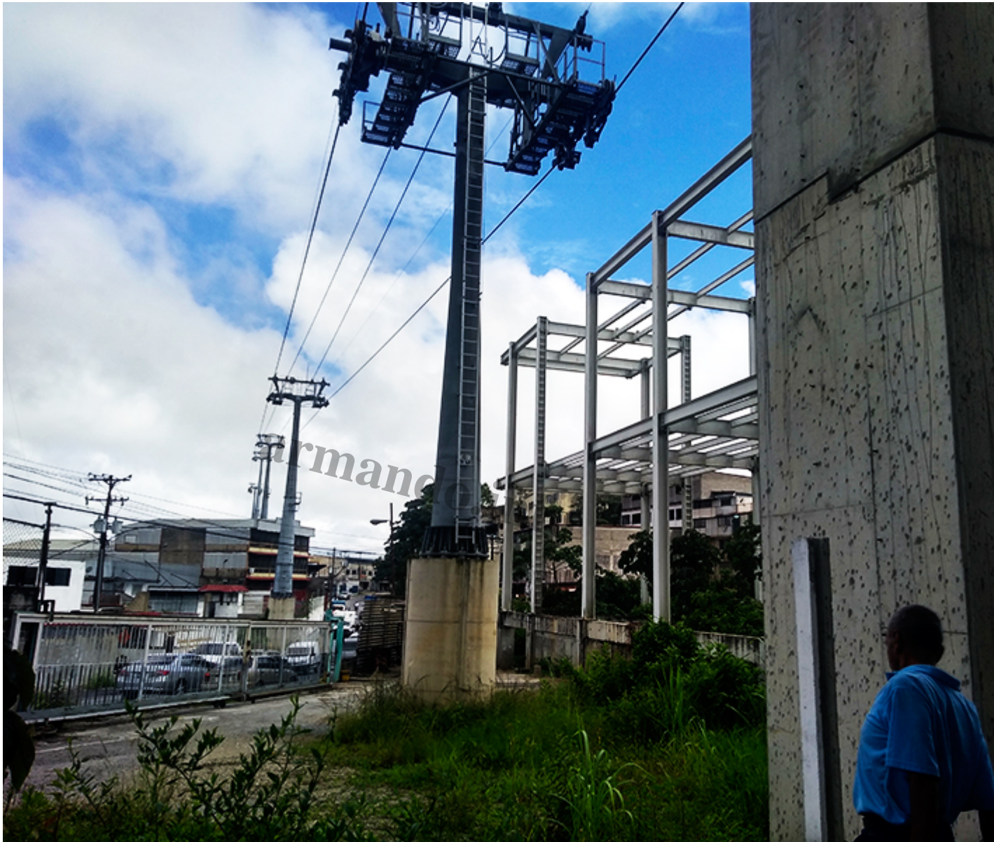
Desidia y abandono es lo Único que ostentan las obras inconclusas de Odebrecht
