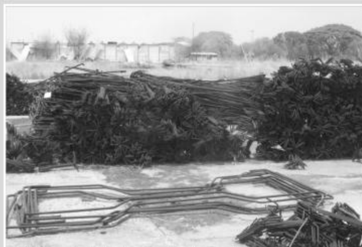
Un cementerio de hierro y estructuras caídas en el campamento donde iba a construirse la estación Tinaco del tren Tinaco-Anaco.
